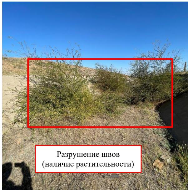
Фото Б.11 - Общие виды характерных дефектов и повреждений
