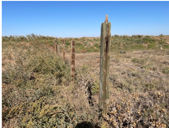
Фото Б.17 - Общий вид ограждений (деревянных) в юго-восточной части полигона
