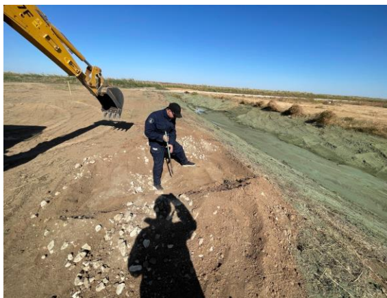
Фото Б.15 - Общий вид вскрытия шурфа до бентонитового мата на краю карты
